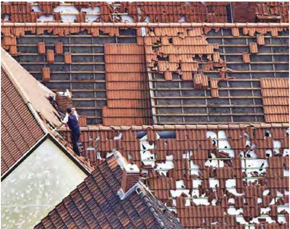
Bei Hagel können Dachziegel und Dachfenster brechen.
